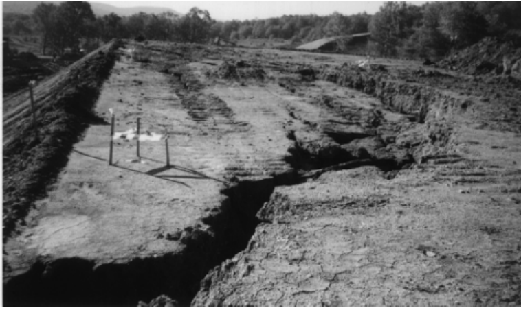
Рис. 3. Разрушение восточного откоса на КС «Краснодарская» газопровода «Россия – Турция», в результате открытия в подошве траншеи
