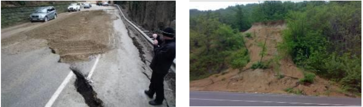
Рисунок 3.6 – Различные проявления оползневого события на низовом и верховом откосах автомобильной дороги
