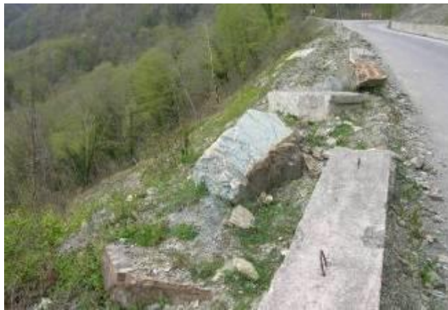
Рисунок 3.7 – Продукты выветривания, сброшенные на низовой откос при эксплуатации автомобильной дороги
