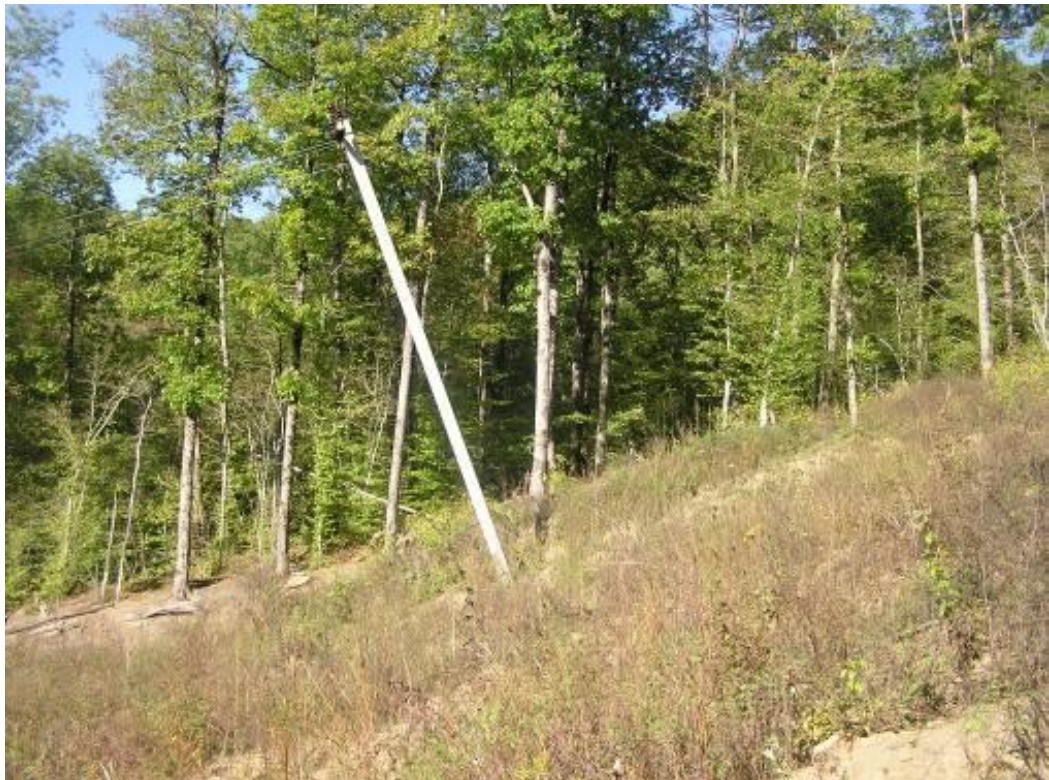
Рисунок 5.16 – Смещение по склону и отклонение от вертикали опоры № 4746 вдольтрассовой ВЛ 10 кВ на ПК287–ПК288 трассы газопровода «Россия–Турция»
