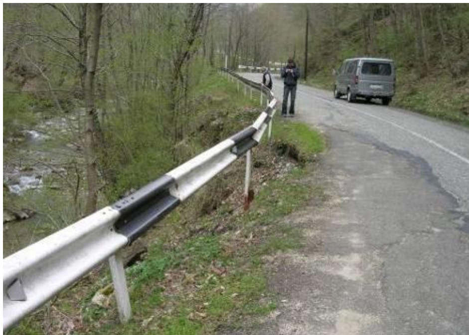
Рисунок 5.2 – Деформации низового откоса и дорожного полотна на ТПТС Макопсе – Наджиги (км 5+300)
