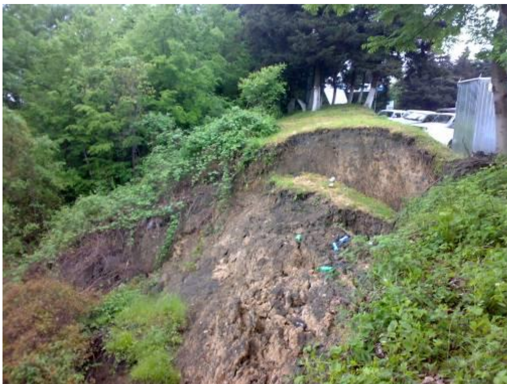
Рисунок 1.3 – Прогрессирующее развитие оползневого процесса на участке трассы М-27 Джубга – Сочи, км 41+700 (июнь, 2011 г.)
