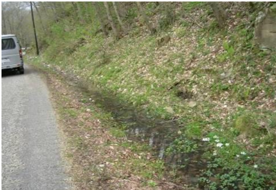
Рисунок 5.6 – Застой воды в подошве откоса полувыемки на ТПТС Макопсе – Наджиго, км 5+300
