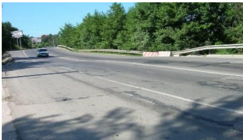
Рисунок 4.2 – Оползневой участок автомобильной дороги Обход г. Сочи, км 3+225 – км 3+900 (2012 г.)
