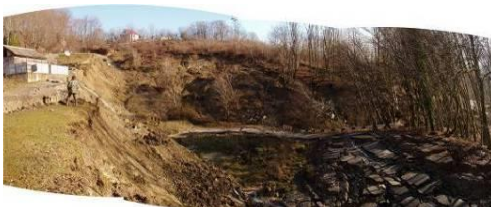
Рисунок 2.8 – Сложный оползень (автомобильная дорога Хоста – Верхняя Хоста, км 6)
