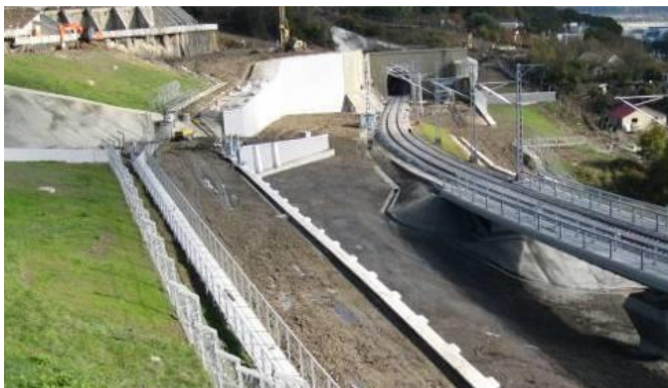
Рисунок 5.14 – Общий вид на построенный железнодорожный тоннель и припортальное сооружение линии Адлер – аэропорт
