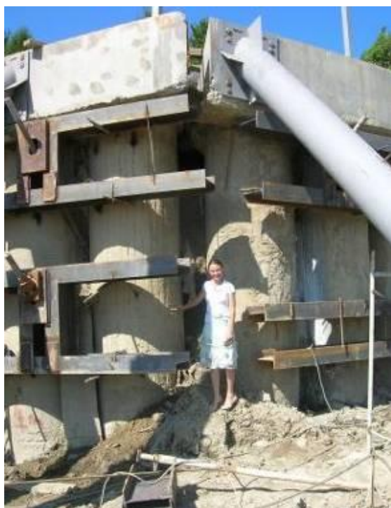
Рисунок 5.9 – Смещение секций строящейся подпорной стены друг относительно друга более 20 см в верхней части (площадка ВОХР, железнодорожная линия Адлер – аэропорт, 2011 г.)
