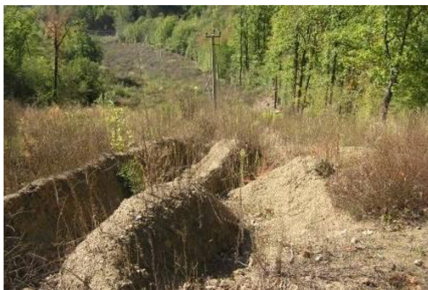
Рисунок 5.20 – Развитие системы эрозионных промоин (вид вниз по склону от опоры № 4745) на ПК287–ПК288 вдольтрассовой Вл 10 кВ
