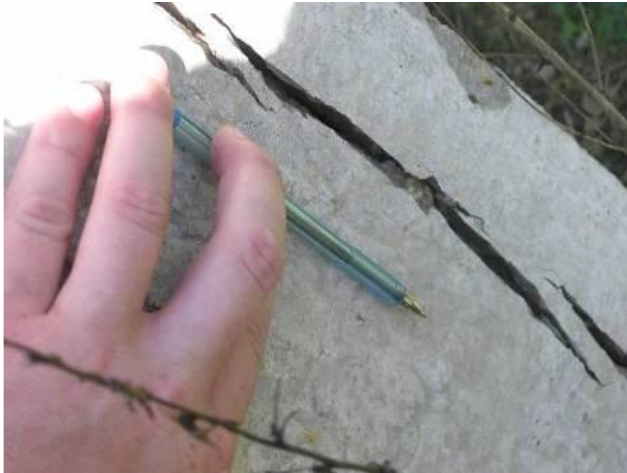
Рисунок 5.17 –Разрушение конструкции опоры № 4747 вдольтрассовой ВЛ 10 кВ на ПК287–ПК288 трассы газопровода «Россия–Турция»
