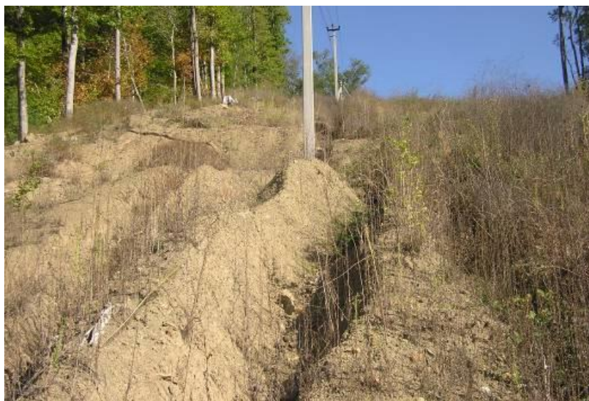
Рисунок 5.19 – Развитие системы эрозионных промоин (вид вверх по склону от опоры № 4745) на ПК287–ПК288 вдольтрассовой Вл 10 кВ
