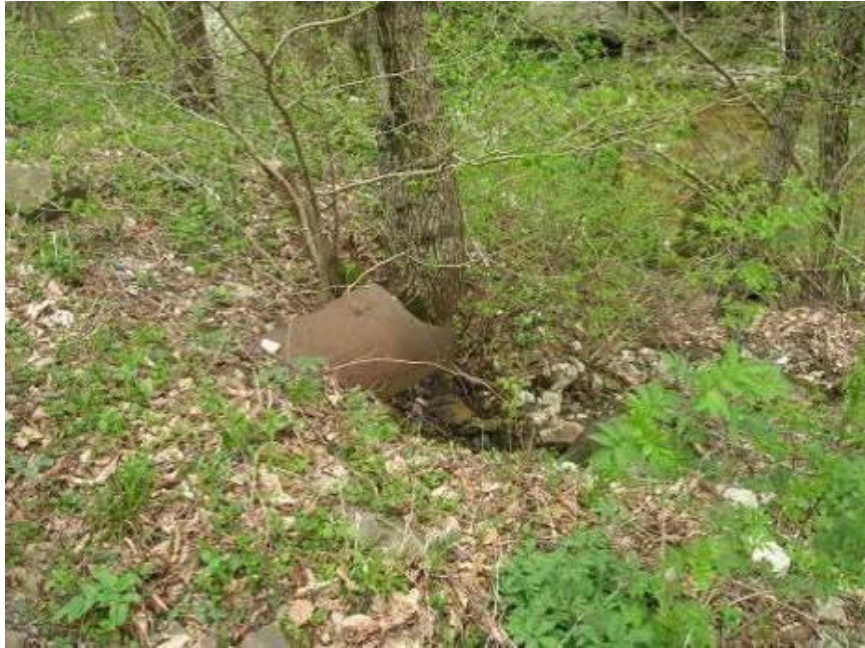
Рисунок 5.3 – Деформированная оползневыми массами труба водопропуска на низовом откосе ТПТС Макопсе – Наджиго, км 5+300
