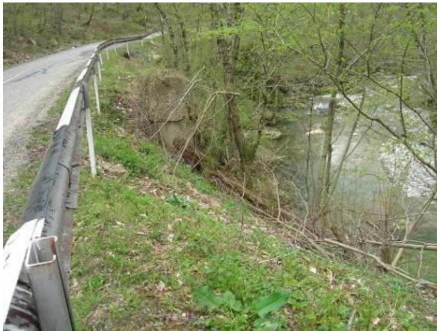
Рисунок 5.4 – Подверженная деформациям подпорная стена на низовом откосе ТПТС Макопсе – Наджиго, км 5+300
