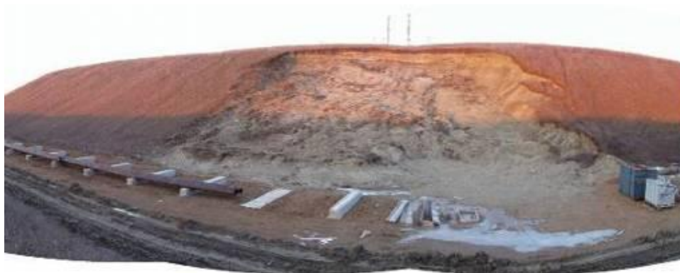
Рисунок 2.7 – Оползень-оплывина (аммиакопровод в районе балки «Куцая» п/о Тамань)
