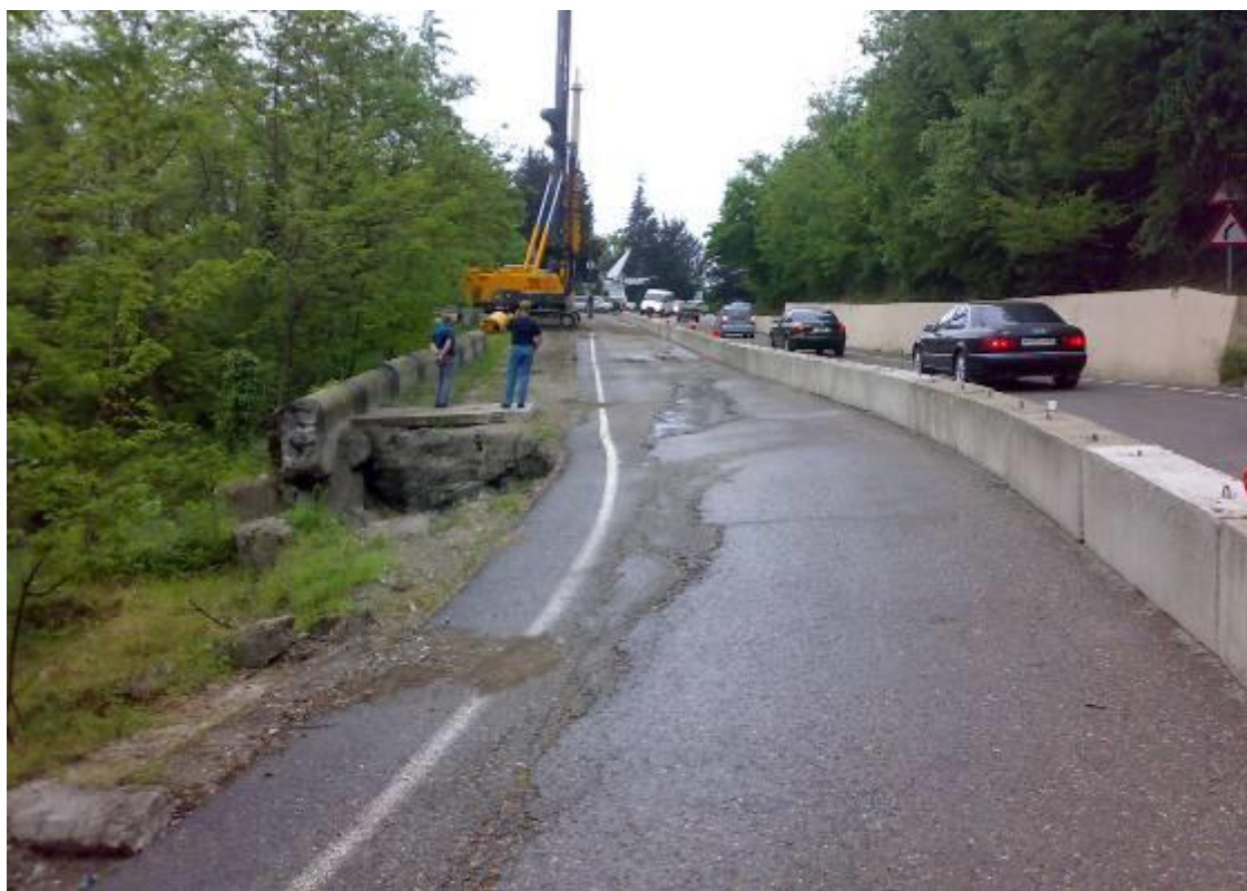
Рисунок 1.2 – Оползневой процесс с низовой стороны участка федеральной автомобильной дороги М-27 Дзубга – Сочи, км 41+700 (апрель, 2011 г.)
