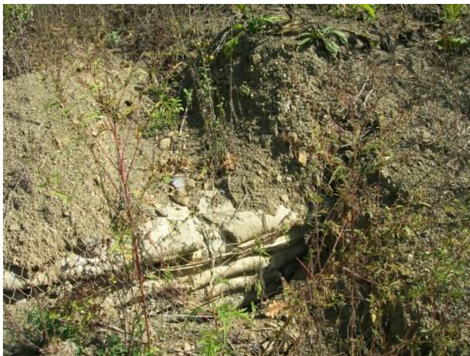
Рисунок 5.21 – Деформация противозэрозийной перемычки на ПК287–ПК288 вдольтрассовой Вл 10 кВ газопровода «Россия – Турция»
