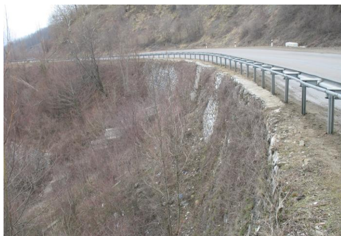
Рисунок 3.8 – Труднодоступная для эксплуатационного содержания низовая подпорная стена
