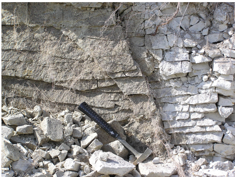
Рис. 4.18. Трещины в мергелях сантонского яруса ( K_{2st} ) в районе пос. Болваново
