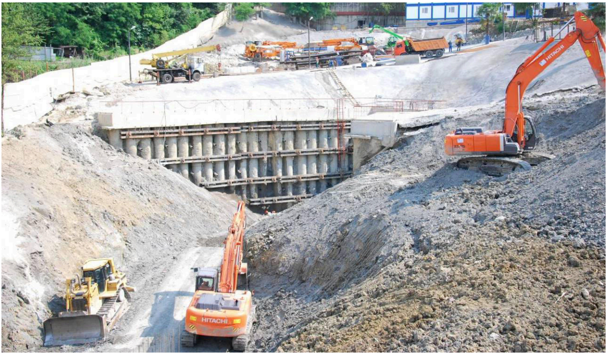
Рис. 57. Промежуточный доступ к тоннелям 8 и 8а. Подпорные сооружения из шпунтового ряда свай.
