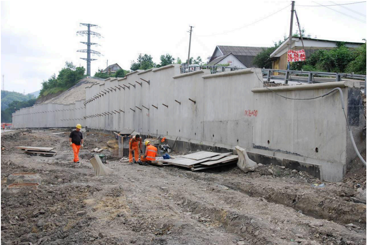
Рис. 66. Общий вид подпорных стен с водоотводным лотком, двойным рядом анкеров и дренирующими отверстиями.
