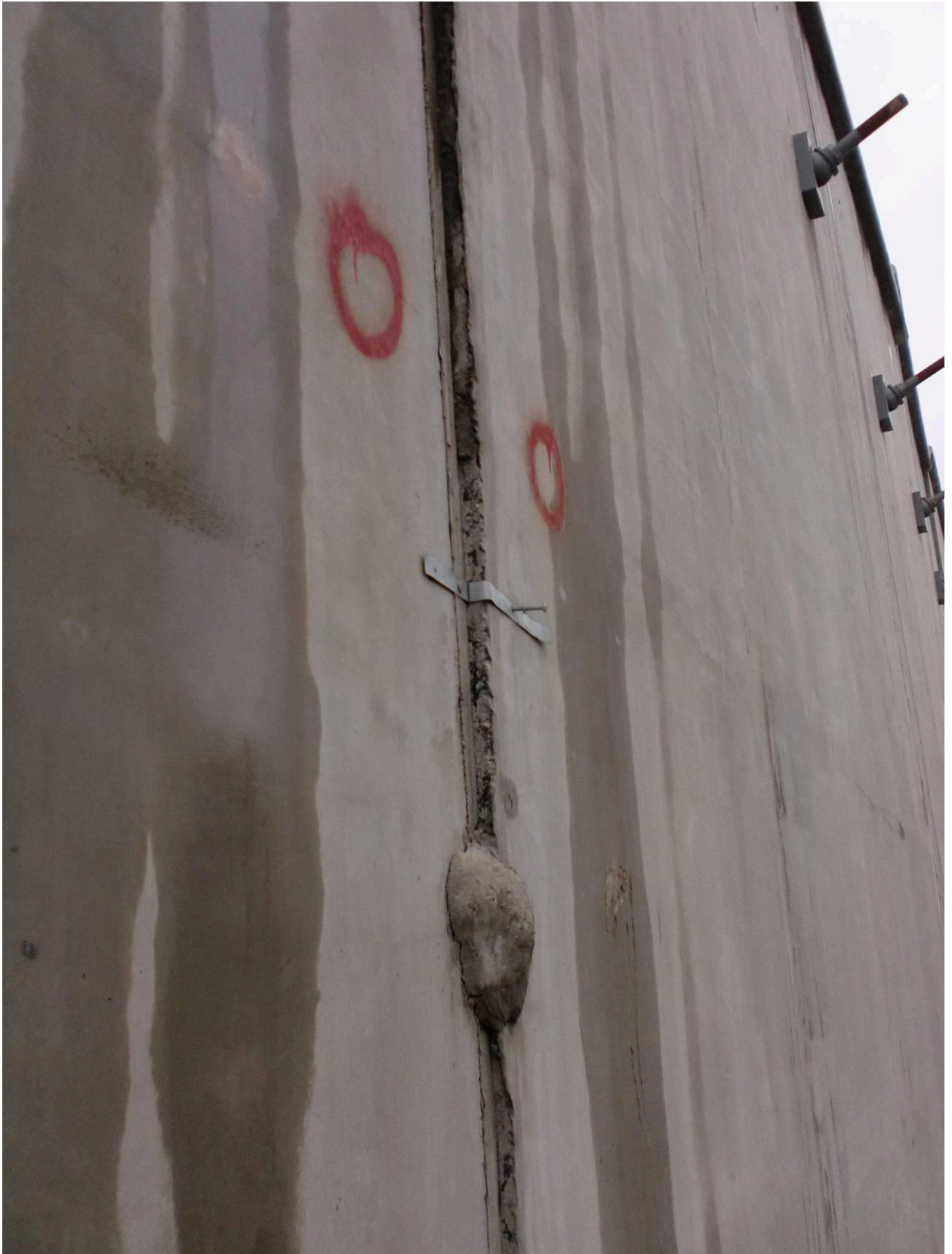
Рис. 67. Деформации подпорных сооружений на ул. Транспортная.
