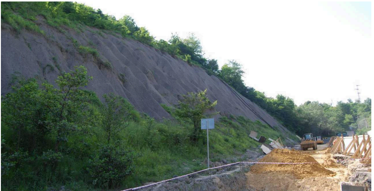
Рис. 68. Незакрепленный склон, сложенный аргиллитоподобными глинами.
