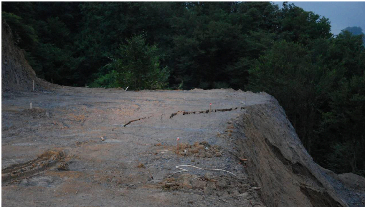
Рис. 55. Трещина отрыва на подошве второй ступени подрезки склона.
