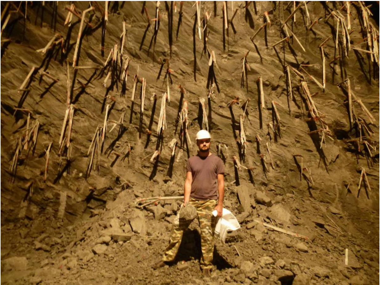
Рис. 61. Забой тоннеля 8а. Грунтовый массив аргиллитоподобных глин, закрепленный с помощью стекловолоконных армирующих элементов.
