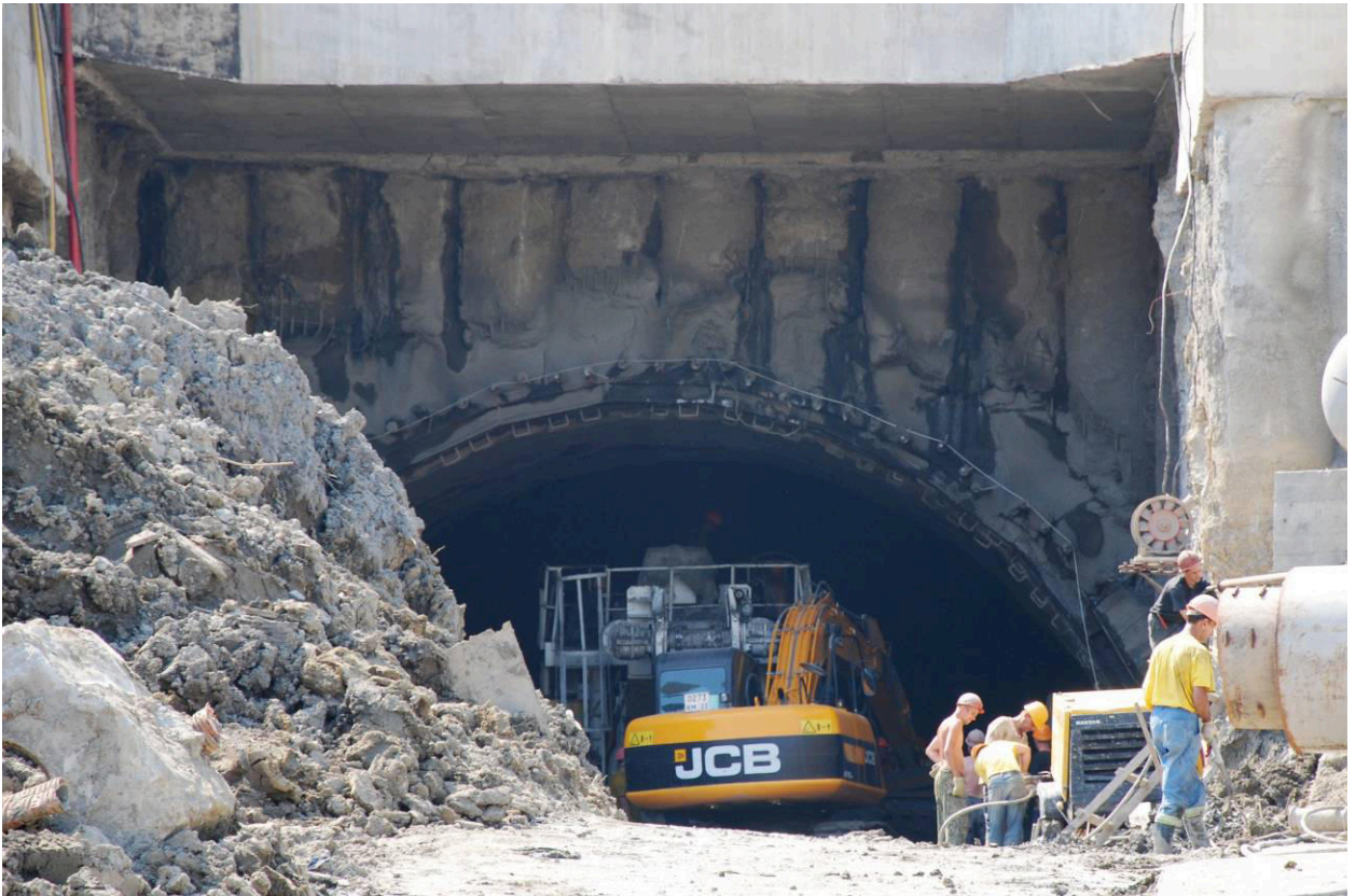
Рис. 59. Укрепительные сооружения на северном портале тоннеля №6. Строительство тоннелей №№ 8 и 8а. Обрушение конструкции жилых зданий над створом тоннеля.
